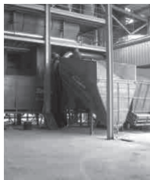
► Vista parcial dos silos situados no CAVI e do carro mesturador fixo, situado no interior da nave
